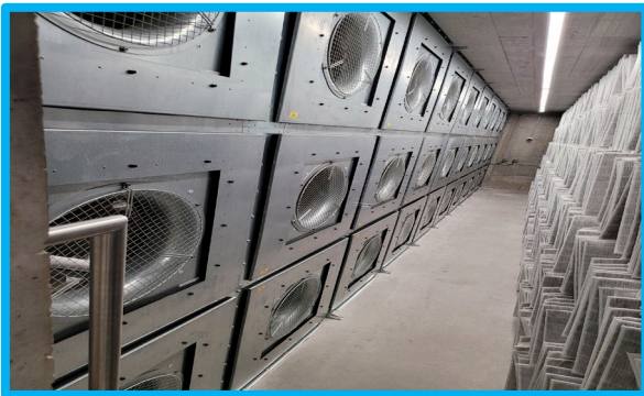
Système de ventilation d'Infomaniak, utilisé afin de chauffer les foyers ©Ferreira David.
